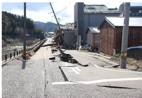
輪島市役所近く、河原田橋付近の陥没した道路
