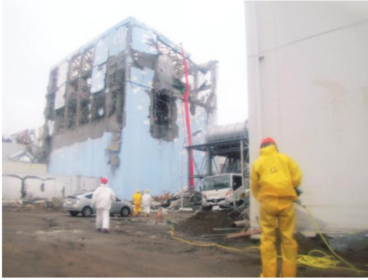
水素爆発をした4号機の1週間後。建屋近くには防護服や全面マスクを着用した作業員の姿が見える=2011年3月22日（写真：東京電力ホールディングス）
